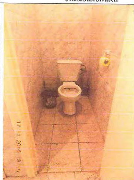
Фото № 149 Кабина санузла
