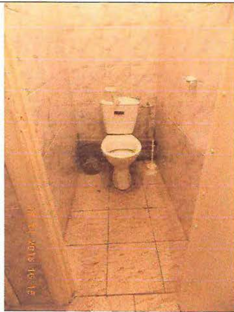
Фото № 150 Кабина санузла
