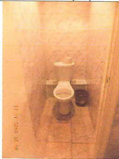
Фото № 160 Кабина санузла
