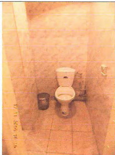
Фото № 151 Кабина санузла
